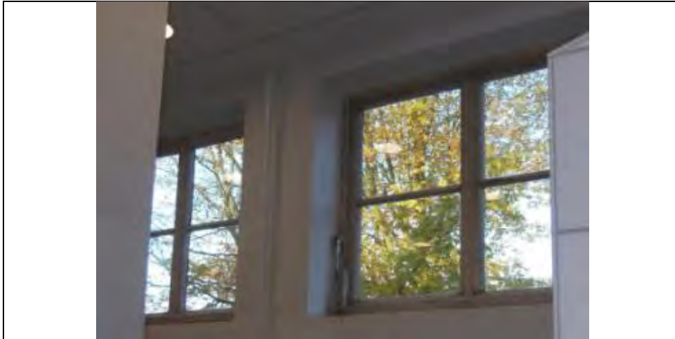
Undichte Fenster, mangelhafter Wärmeschutz
