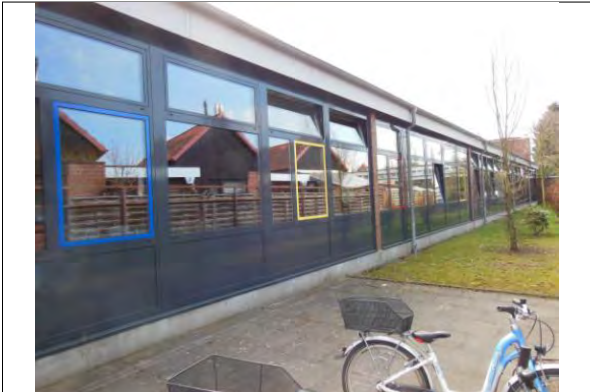
Ungedämmte Metallfenster und mangelhaft gedämmte Kassetten unter den Fenstern
