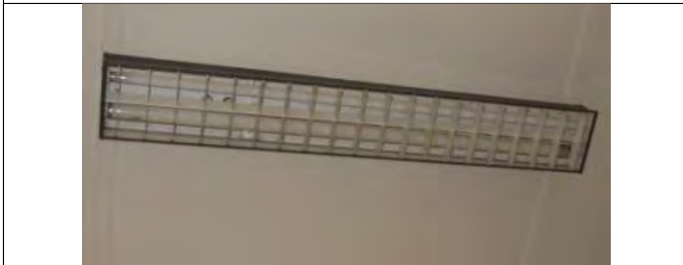
Ineffiziente Leuchten ohne Reflektor und mit veralteten konventionellen Vorschaltgeräten (KVG).
