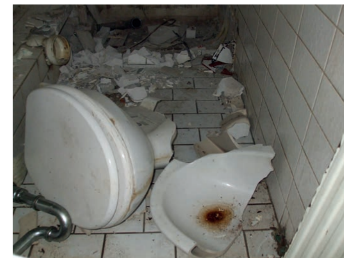
2. Beispiel für das Fehlen von funktionsfähigen und nutzbaren sanitären Einrichtungen in einer Wohnung. Foto: Stadt Delmenhorst.
