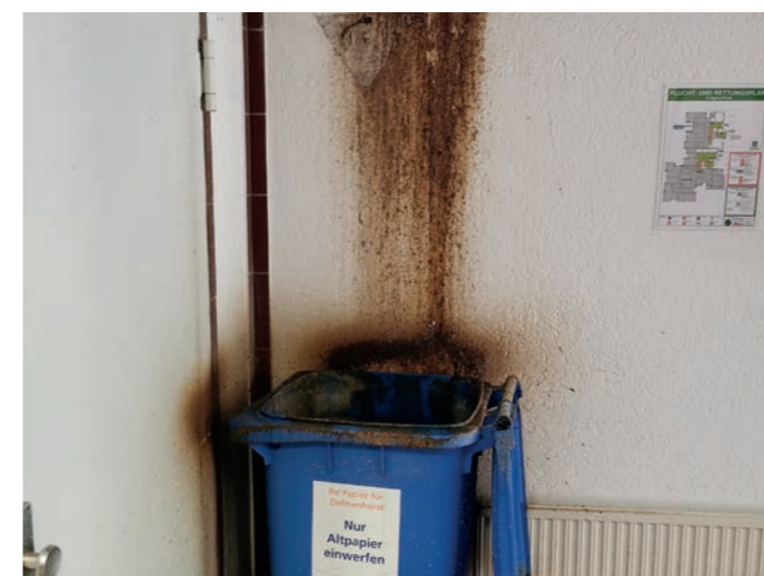
3. Beispiel für eine mangelhafte Beseitigung der Abwässer (hier: Abwasserrohrbruch). Foto: Stadt Delmenhorst.
